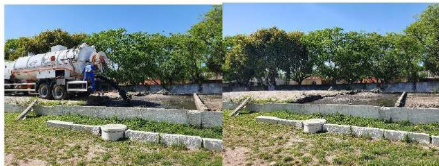
Figuras 67 e 68. Leitões de secagem de lodo de limpeza de galeria de macrodrenagem – RALF.
